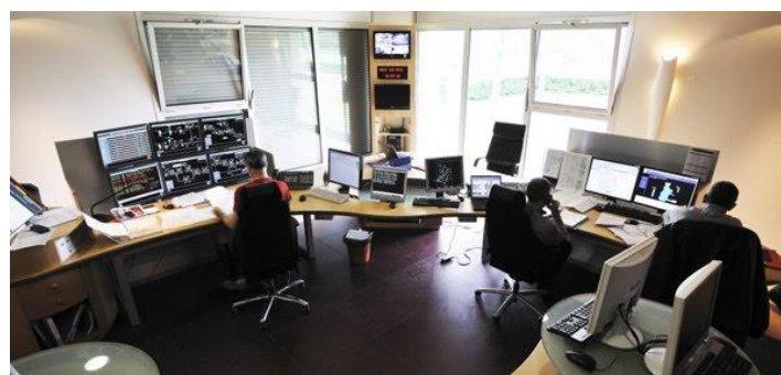
Figure 42 : Photo de la salle de contrôle
