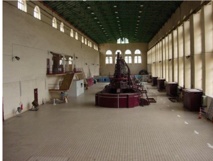
Figure 41 : Photo de la salle des machines (turbines Kaplan)
